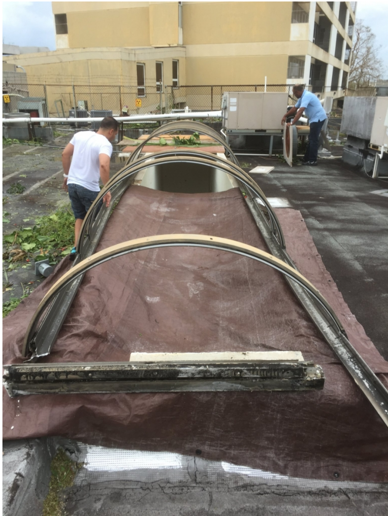
Daños en la tragaluz de la clínica RTCI en San Juan.
